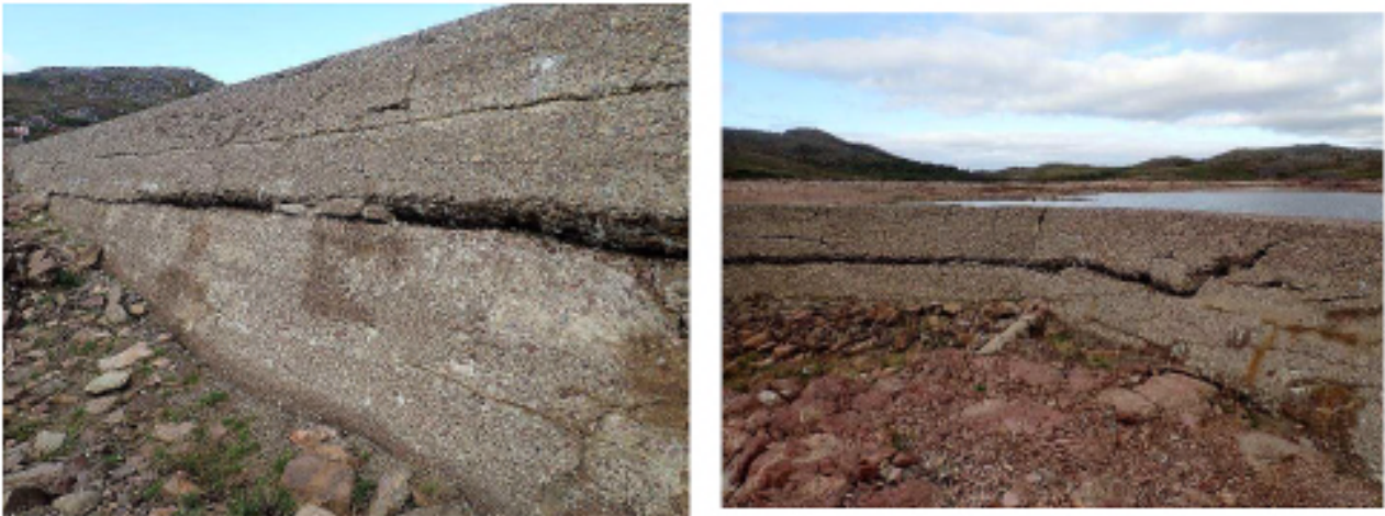
Figure 6 : Fissures horizontales sur l'ancien barrage amont
