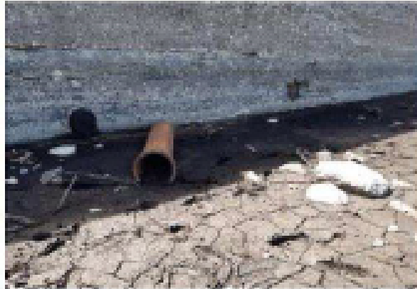
Figure 13 : Ancienne conduite au droit d'un bras de l'ancien lit du ruisseau (Source : Reconstruction du barrage de la Vigie – Phase 1 – Rapport de diagnostic. ARTELIA, 2021)
