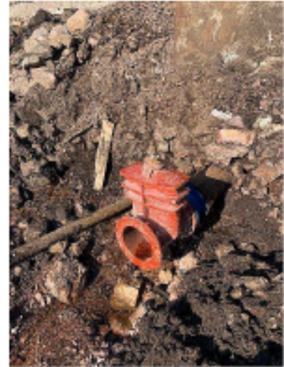
Vanne Pont-à-Mousson Ø300 – débit de restitution de 0 à 4,5l/s, mise en place par la ville de St Pierre le 22/09/21
