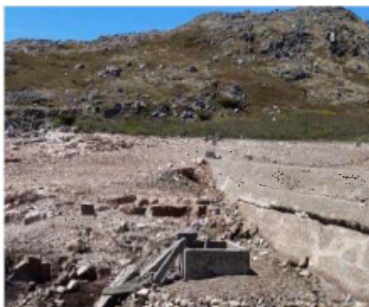
Figure 12 : Vue de la chambre de vanne en puits à l'aval du barrage (Source : Reconstruction du barrage de la Vigie – Phase 1 – Rapport de diagnostic. ARTELIA, 2021)
