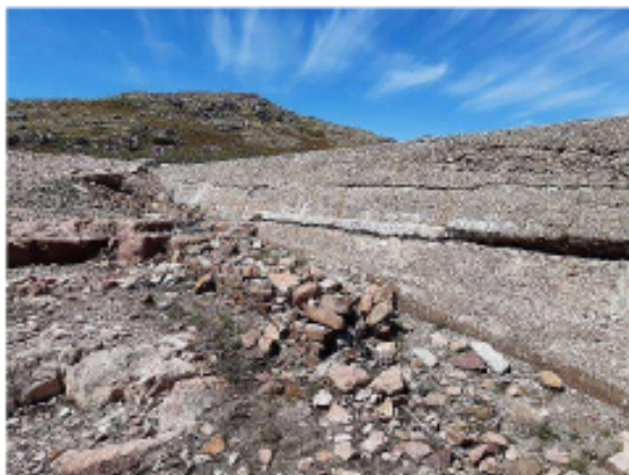
Figure 11 : Aperçu de l'endommagement du batardeau amont (Source : Reconstruction du barrage de la Vigie – Phase 1 – Rapport de diagnostic. ARTELIA, 2021)
